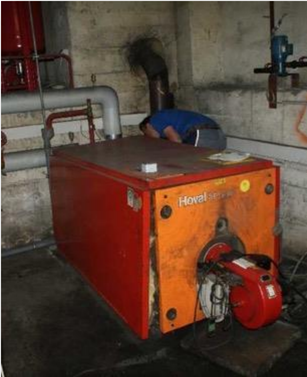
Quelle: Kurs der Kantone Luzern/Aargau „Heizungs-Check“
